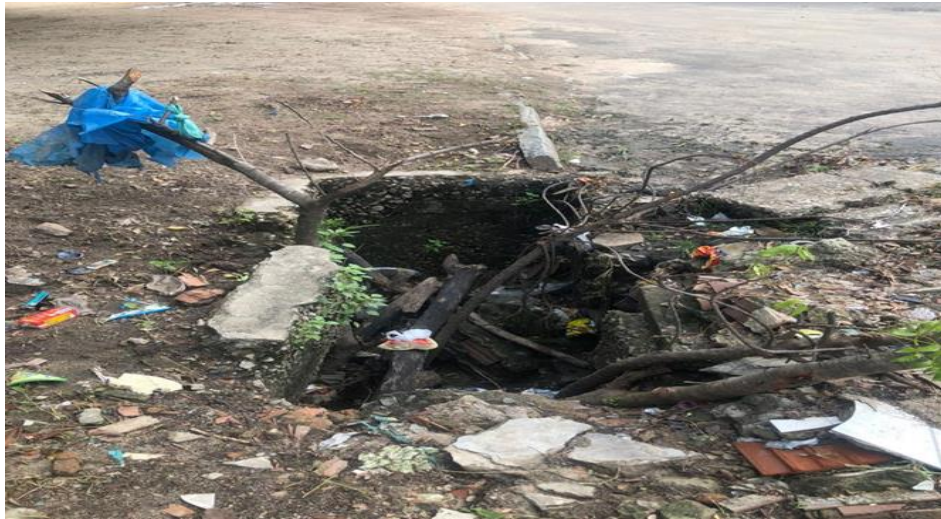
Figura 5 – Obstrução dos componentes do sistema de drenagem
