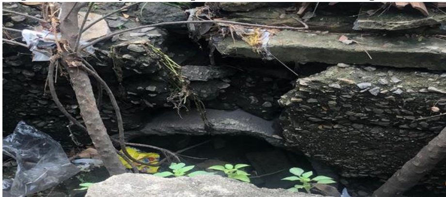
Figura 6 – Obstrução dos componentes do sistema de drenagem
