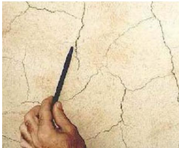
Figura 1- Exemplo de fissura
